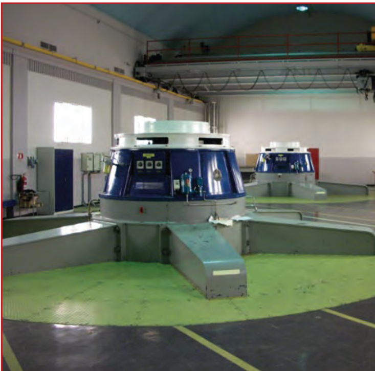
Рис. 2. Генераторный зал ГЭС Аунфосс
