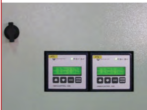
Рис. 7. Два блока контроля вибрации VC-1500 в шкафу контрольного оборудования.
